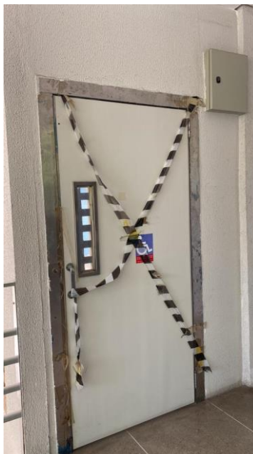
Figura 15 - Elevador Pavimento Superior
