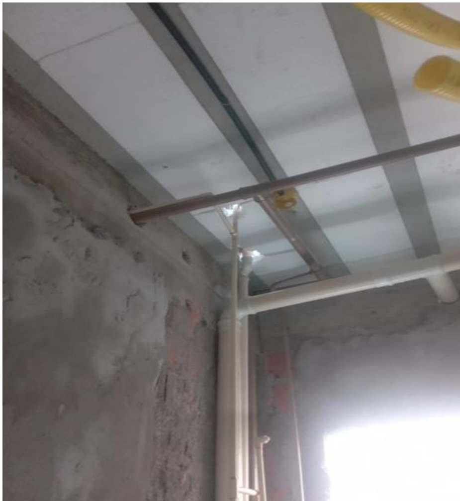
Figura 9- Tubulação de água fria de Obra A atravessando uma viga sem proteção.
