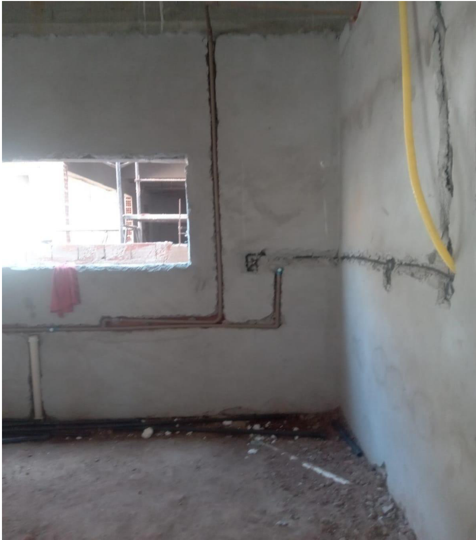
Figura 7 - Tubulações desalinhadas na Obra A.
