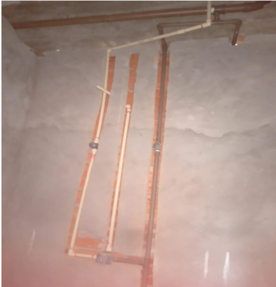
Figura 8 - Tubulações desalinhadas na Obra A.
