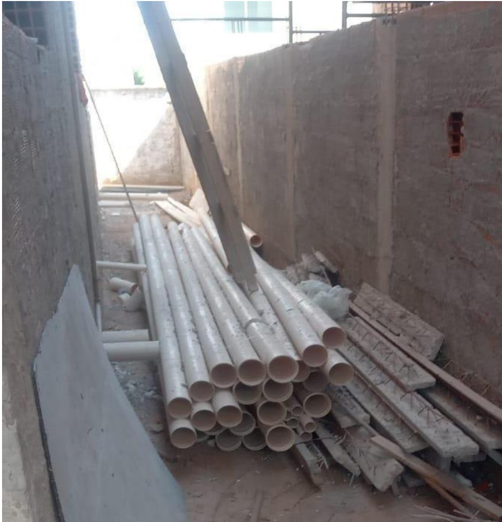
Figura 5- Materiais da obra A armazenados de maneira inadequada.
