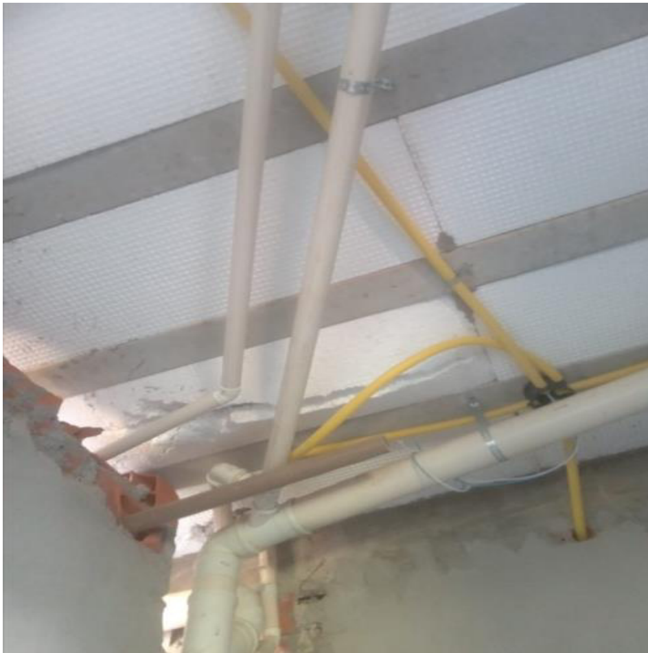
Figura 10 - Tubulação de esgoto sanitários próxima a tubulações de águas pluviais da Obra C sem métodos de identificação.
