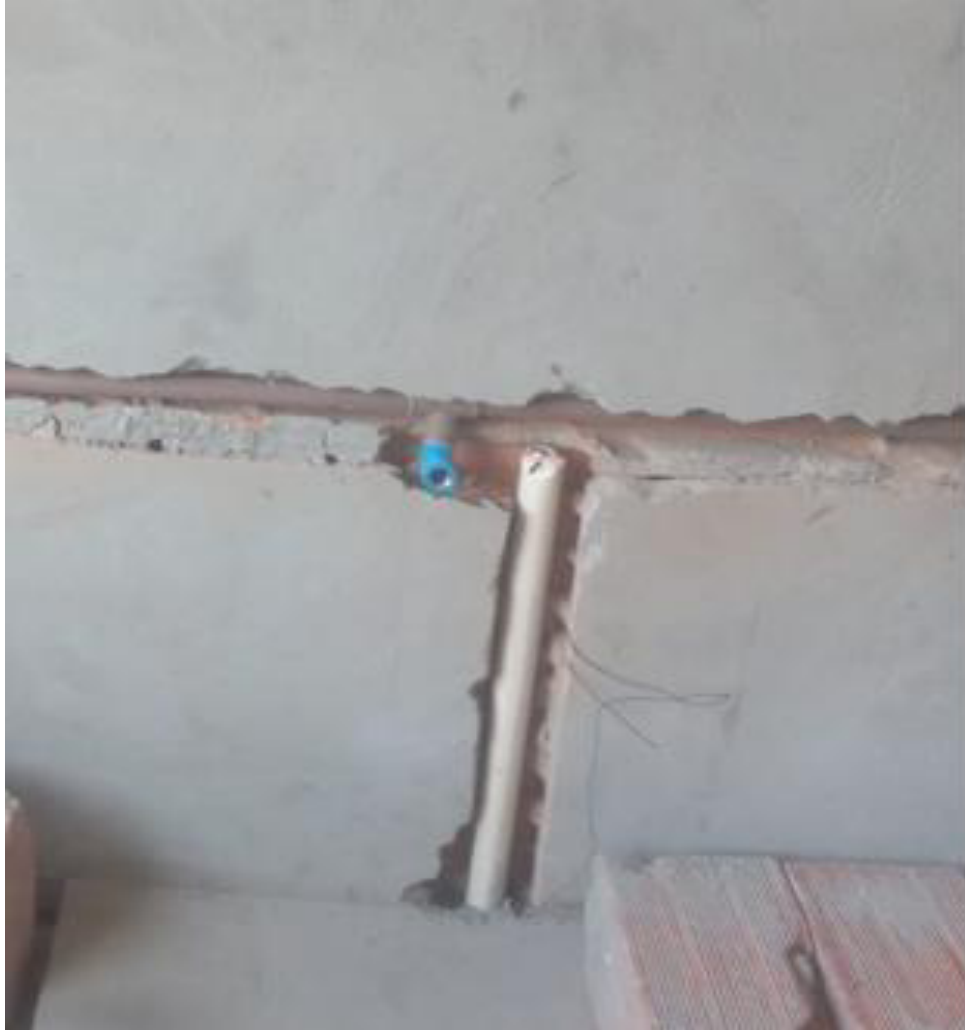
Figura 12 - Tubulação de esgoto da Obra B instalada sem a presença de elementos que absorvam as movimentações e vibrações.
