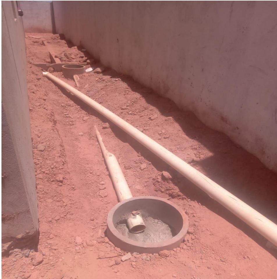
Figura 11 - Assentamento de uma vala na Obra B.
