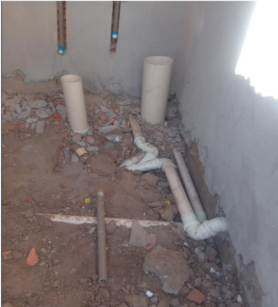
Figura 13 - Tubulações de esgoto da obra A aterradas sem a presença de elementos que absorvam as movimentações e vibrações.
