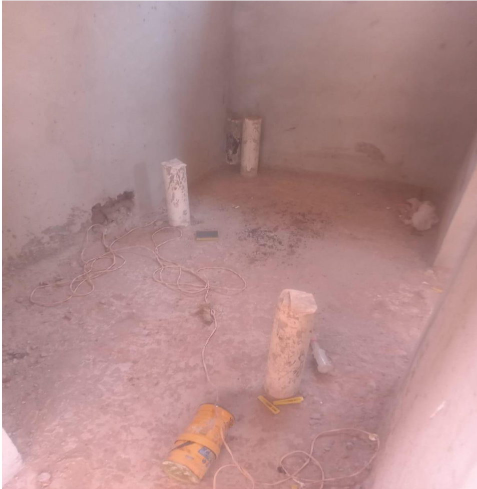
Figura 14 - Tubulações de esgoto da obra B com as aberturas fechadas de maneira inadequada.
