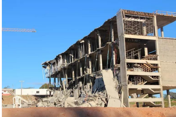
Figura 23 - Colapso da estrutura por punção do Shopping Poty.
