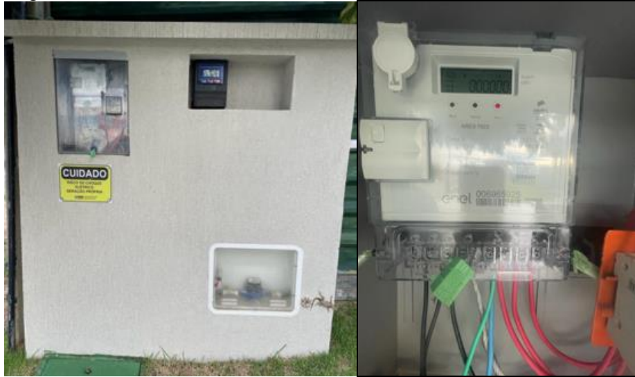
Figura 13 – Pontos de Conexão e Medidor
