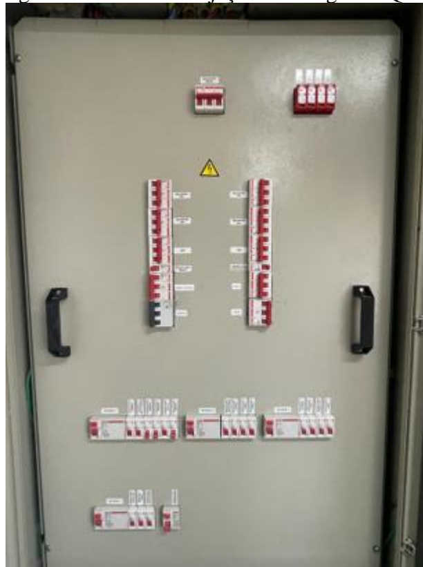
Figura 12 – Ponto de Injeção da energia no QGD
