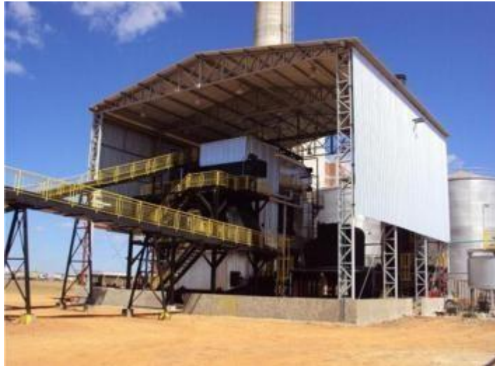
Figura 7: Caldeira de Biomassa.
