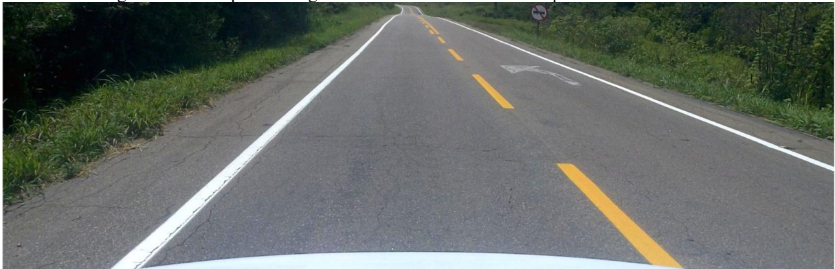
Figura 55 - Exemplo de imagens com trinca no acostamento que não foram detectadas
