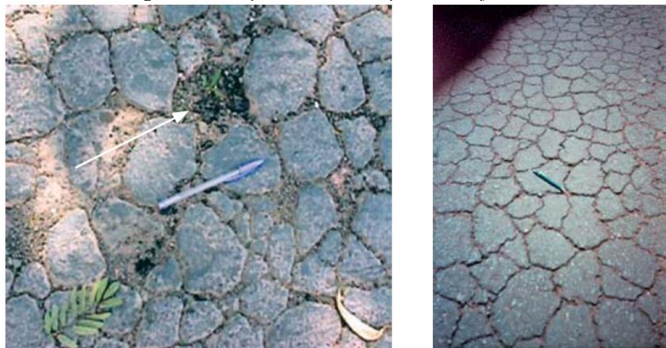
Figura 6 - Exemplo de trincas do tipo couro de jacaré
