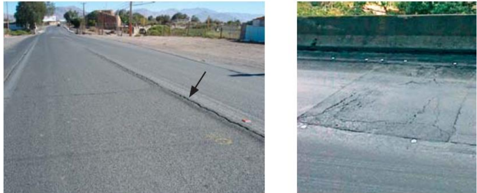
Figura 5 - Exemplo de trincas de retração
