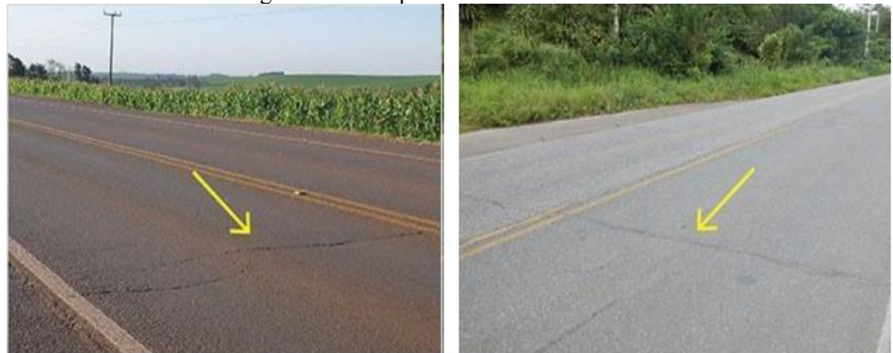
Figura 3 - Exemplo de trincas transversais
