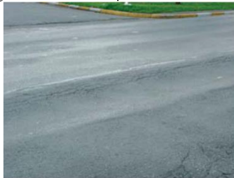
Figura 8 - Afundamento plástico nas trilhas de roda
