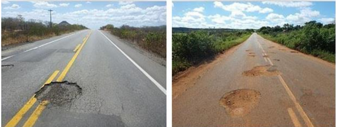
Figura 14 - Exemplo de buracos no pavimento
