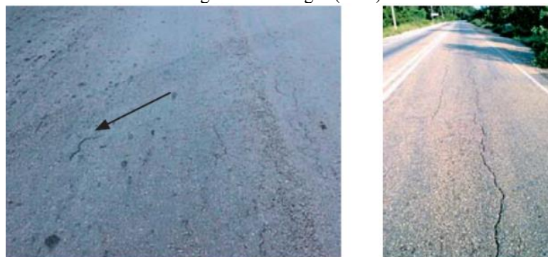
Figura 4 - Exemplo de trincas a) Trincas isoladas curtas longitudinais (TLC) b) Trincas longitudinais longas (TLL)
