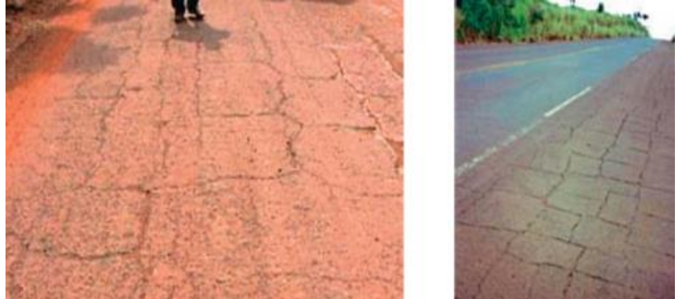
Figura 7 - Exemplo de trincas a) Trinca de bloco com erosão (TBE) b) Trinca de bloco sem erosão (TB)
