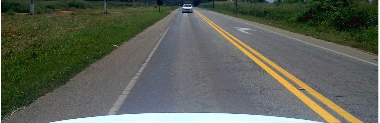
Figura 56 - Exemplo de imagem com trinca na outra faixa de rolamento
