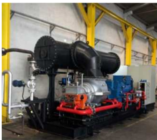
Figura 19- Turbina de contrapressão utilizada no projeto.
