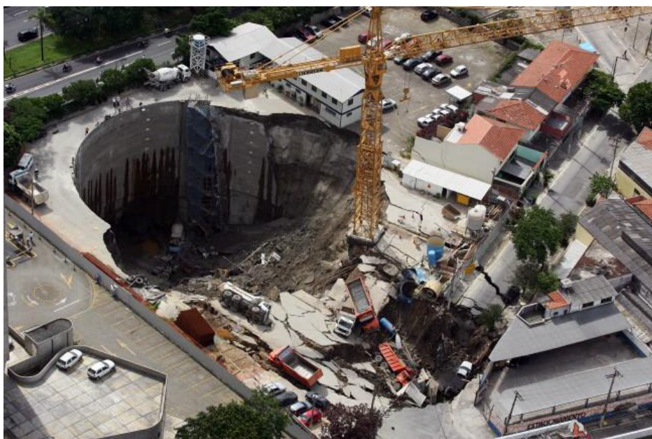
Figura 32 - Cratera aberta devido ao desabamento do túnel.
