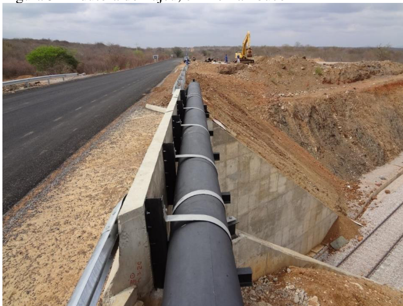
Figura 3 - Adutora do Pajeú, em Pernambuco
