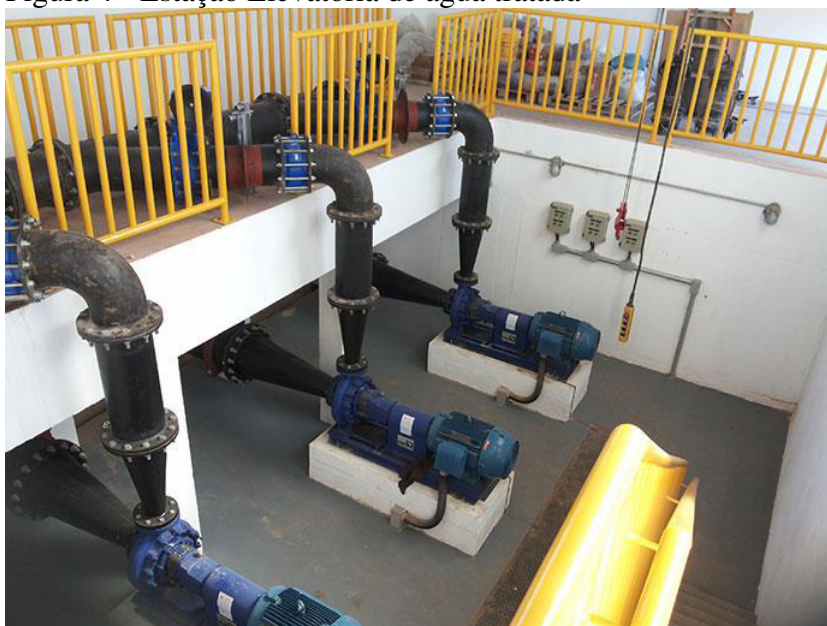
Figura 4 - Estação Elevatória de água tratada
