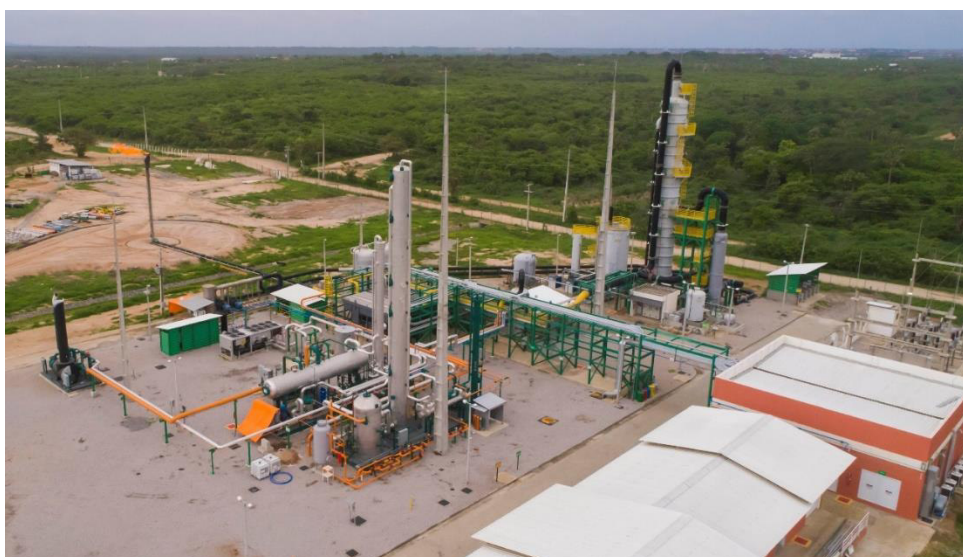
Figura 2 - Usina de biometano GNR Fortaleza
