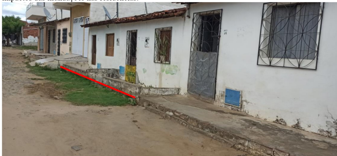
1 – Estruturas de concreto para reduzir a entrada da água nas casas
