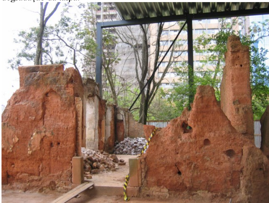
Figura 25 – Aspecto das ruínas da casa do Sítio Itaim, em São Paulo, antes das obras de reconstrução, mostrando o avançado estado de degradação da taipa.
