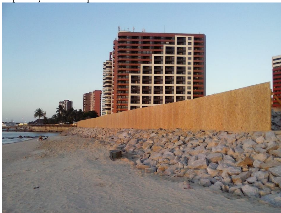
Figura 52 – Aterro sendo realizado na Praia dos Botes para implantação do deck panorâmico do Mercado dos Peixes.
