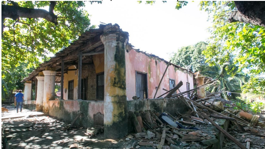
Figura 6 – Chácara Salubre, após desabamento parcial.
