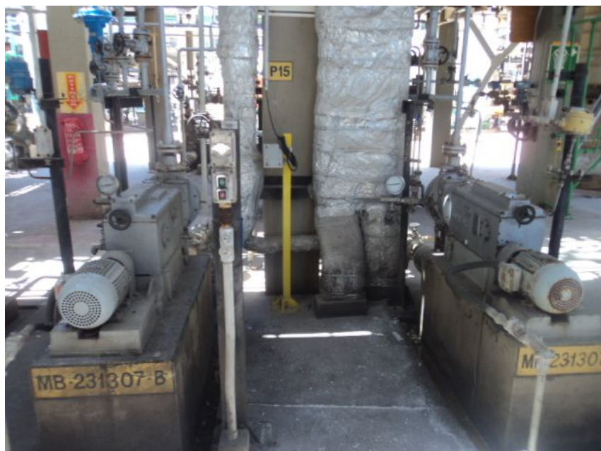
Figura 02 – Conjunto de Bombas em área industrial
