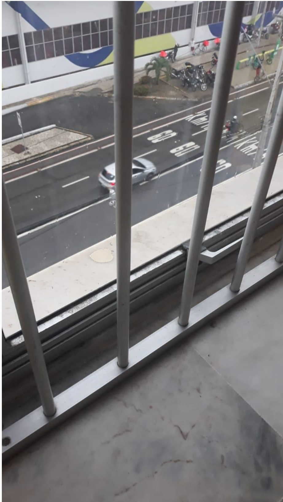
Figura 29 - Detalhe do desgaste do material empregado na esquadria da brinquedoteca
