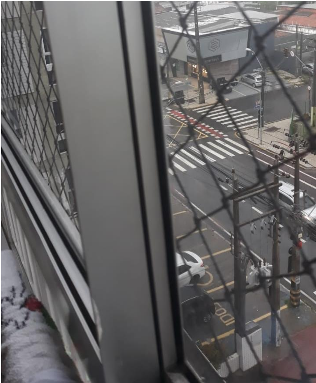
Figura 28 - Detalhe do ressecamento da borracha de vedação na esquadria da brinquedoteca
