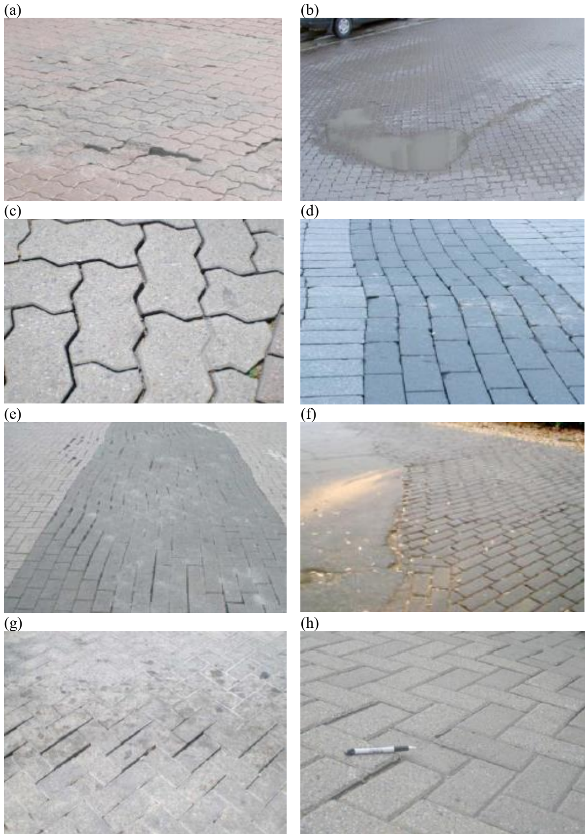
Figura 6 – Defeitos em pavimentos intertravados
