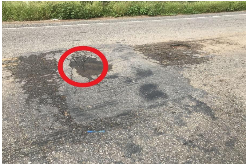
Figura 14 – Fissuras perceptíveis no revestimento asfáltico.
