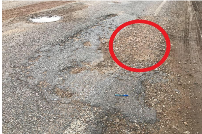
Figura 15 – Desgaste severo do revestimento asfáltico.
