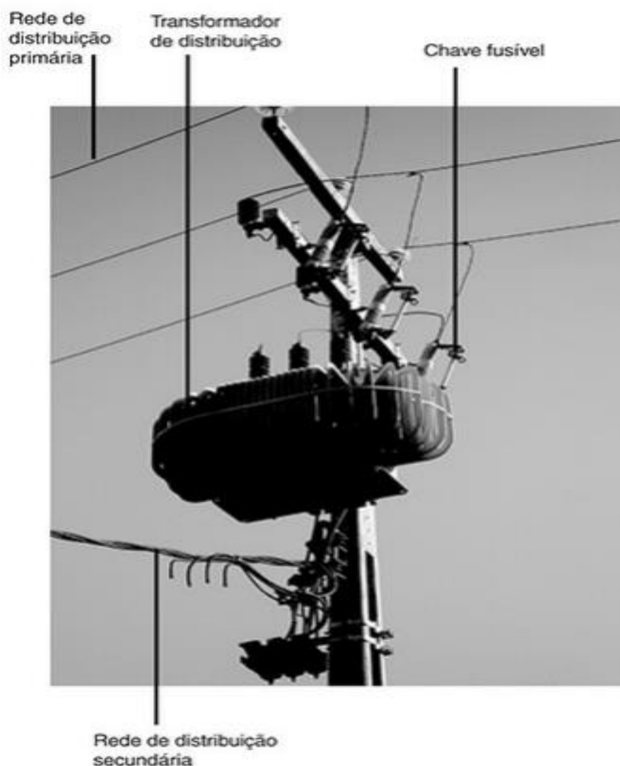
Figura 5- Proteção de um transformador de distribuição
