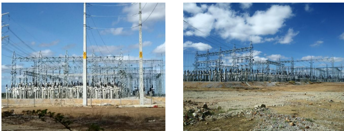
Figura 5 – SE Juazeiro III. Coordenadas: 333419 / 8951050
