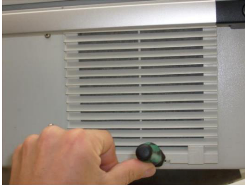
Figura 20 - Troca do filtro de ar no ventilador do filtro Rittal
