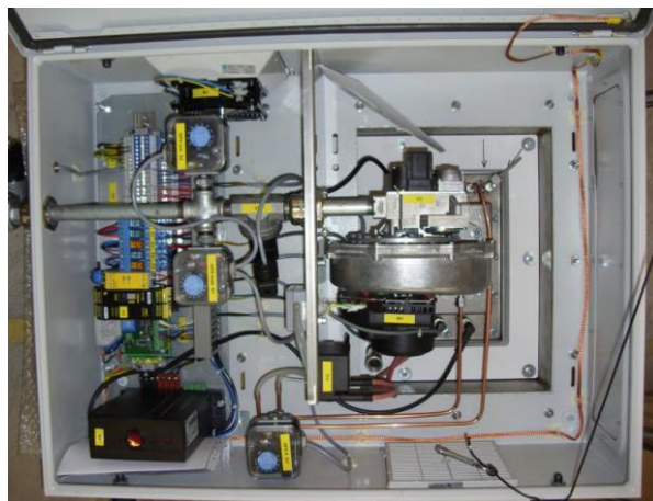
Figura 11 - Caixa de controle do forno a gás: Interno
