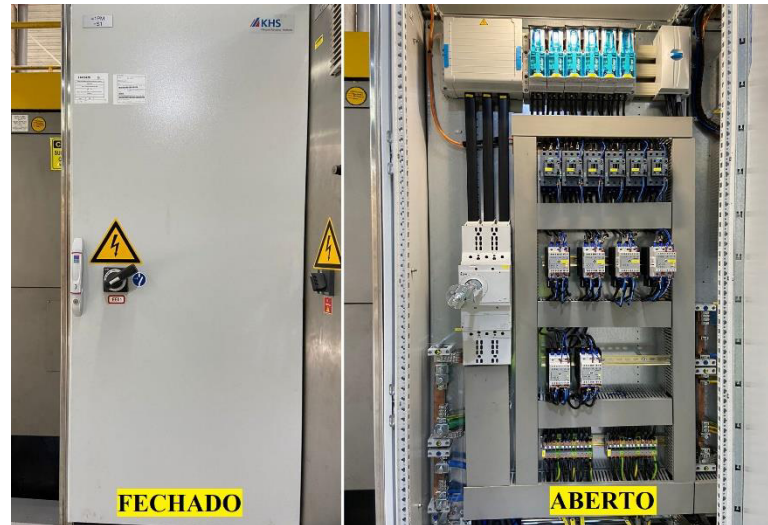
Figura 29 - Painel de comando e proteção dos aquecedores elétricos
