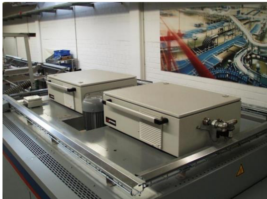
Figura 10 - Caixa de controle do forno a gás: Externo
