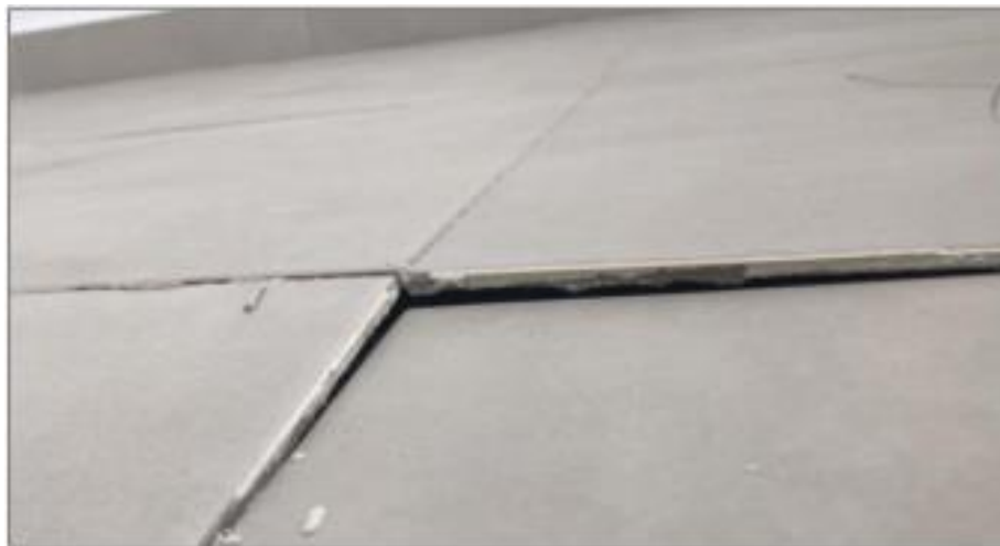
Figura 2 – Placas cerâmicas de piso apresentando estufamento
