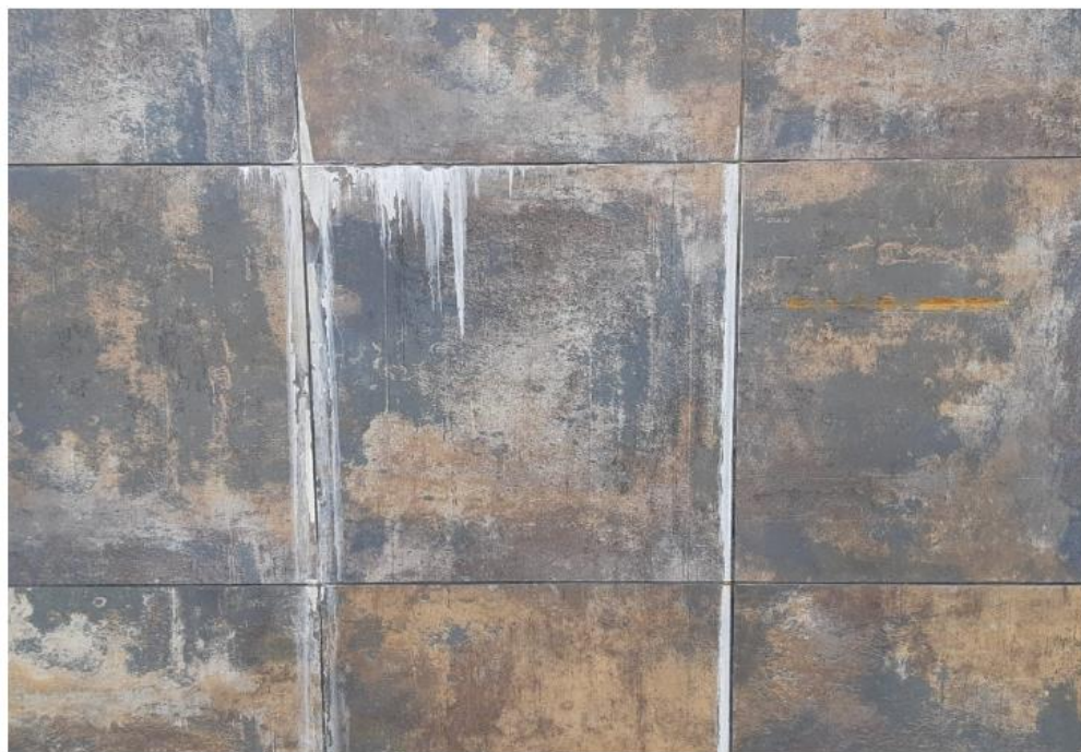
Figura 5 - Fenômeno da eflorescência na placa cerâmica
