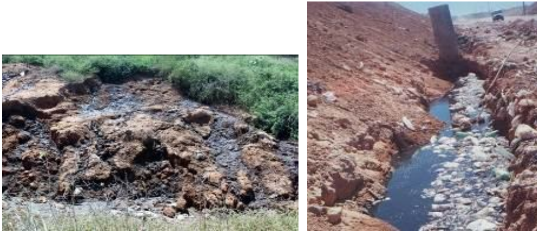
Figura 3. Vazamento de lixiviado pelos taludes das trincheiras T1 e T2. Fonte: Carvalho Jr, F.H.(2011).
