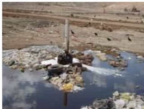
Figura 2. Nível do piezômetro na trincheira T2 e vazamento no pé do talude. Fonte: Carvalho Jr, F.H.(2011).
