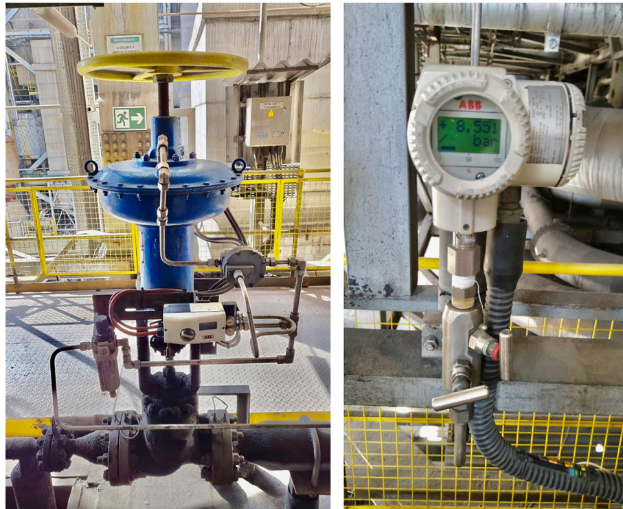
Figura 2 – Válvula de controle e transmissor de pressão.
