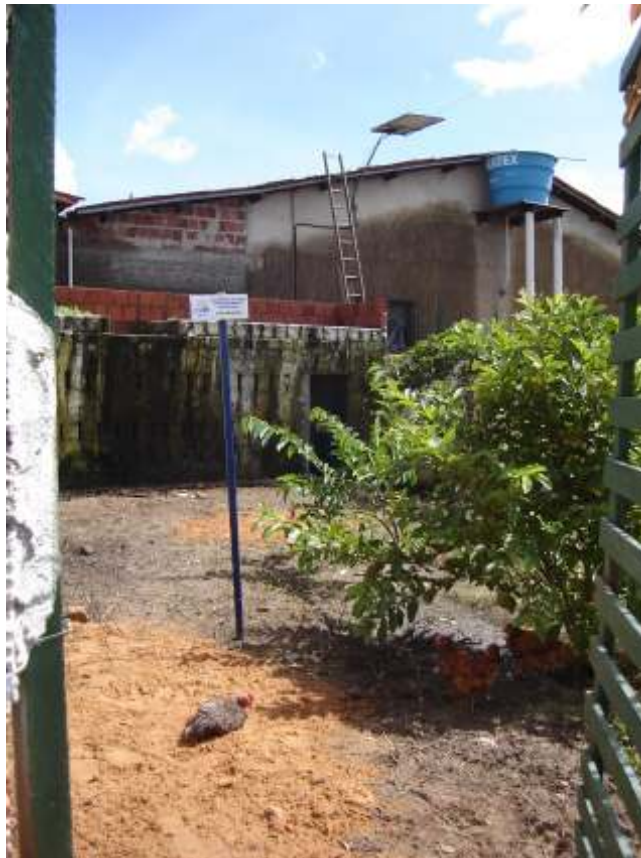
Figura 2: Sistema de irrigação FV (Parque Universitário, Fortaleza)
