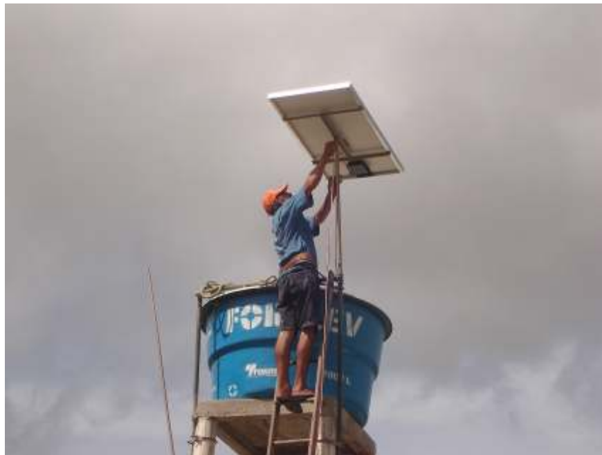
Figura 3: Unidade de bombeamento FV (Itaoca, Fortaleza)
