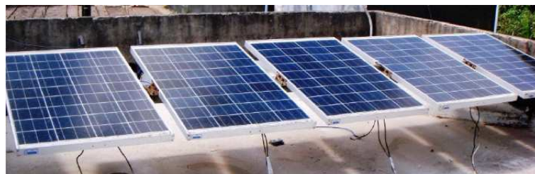
Figura 5 – Painéis FV instalados no LEA.
