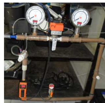
Figura 13 – Instrumentação do Ramal de Biogás.
