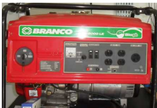
Figura 12 – Gerador de 4 KVA.
