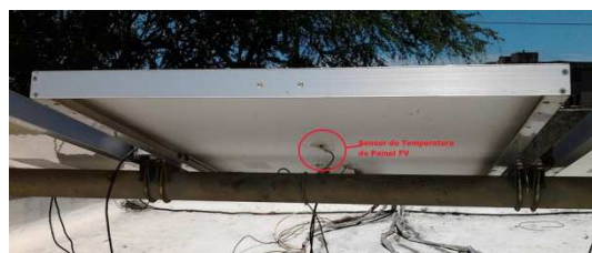
Figura 6 – Sensor de Temperatura LM35 instalado em Painel.
