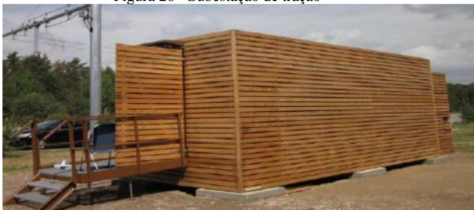
Figura 26 - Subestação de tração
