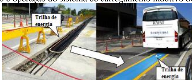
Figura 21 - Construção e operação do sistema de carregamento indutivo dos ônibus OLEV
