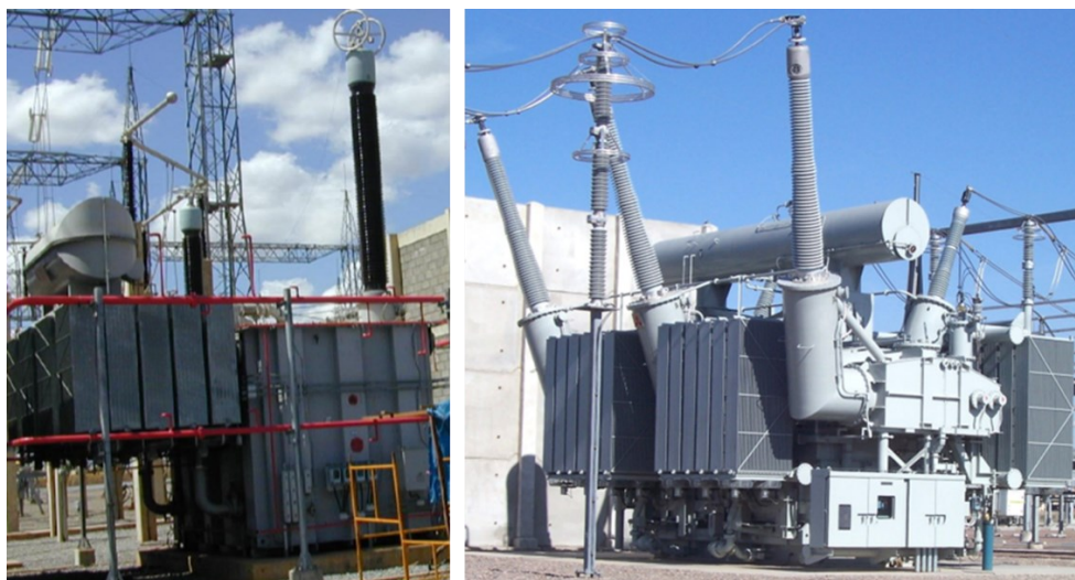
Figura 3 - Transformador de potência monofásico (à esquerda) e trifásico (à direita).
