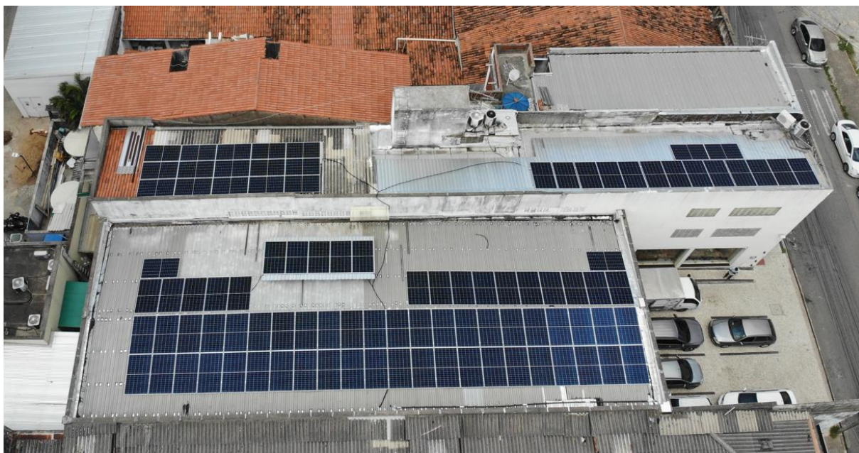
Figura 11 – Módulos FV instalados no telhado do sistema analisado.
