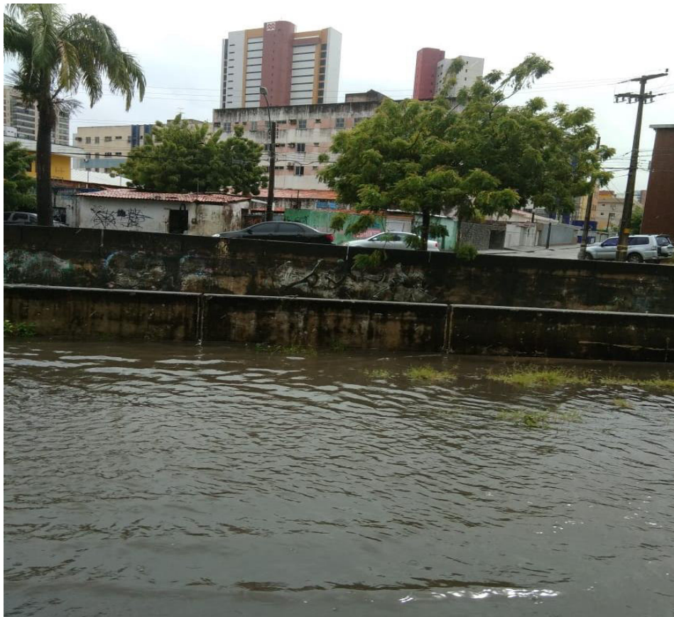
Figura 10 – Alagamento Após Chuva Rápida na Avenida Eduardo Girão, Ano de 2019.
