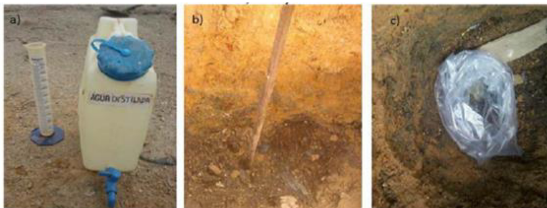
Figura 12 - Processo de Obtenção do Peso Específico a) Equipamento Utilizado no ensaio b) Escavação da Vala c) Ensaio para obtenção do peso específico
