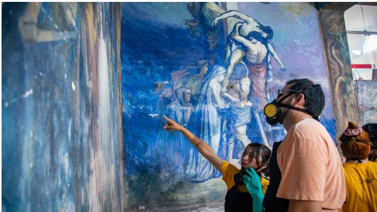
FIGURA 7 – EQUIPE DA EAOTPS NA PRIMEIRA ETAPA DE RESTAURO DOS PAINÉIS ARTÍSTICOS DA IGREJA NOSSA SENHORA DOS REMÉDIOS
