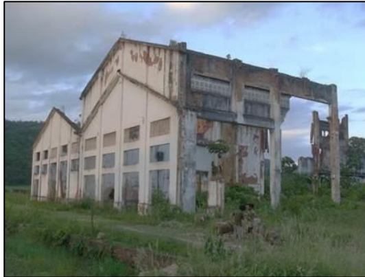
Figura 72 – Foto da Antiga Usina Tanques atualmente (em ruínas) em Alagoa Grande-PB
