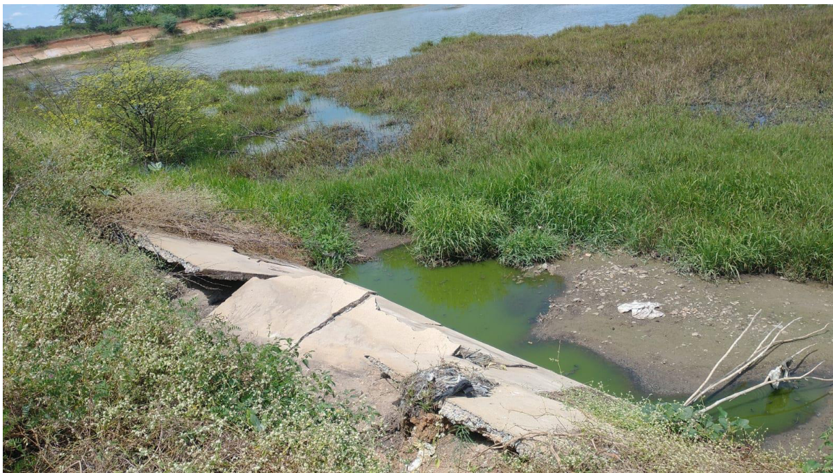
Figura 11 - Estrutura danificada na ETE de Quixeramobim
