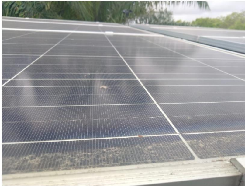
Figura 21 - Sujidade encontrada em PFV1.
