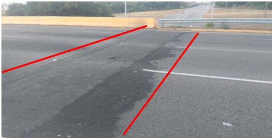
Figura 20 - Degrau em viaduto da Rodovia CE-401
