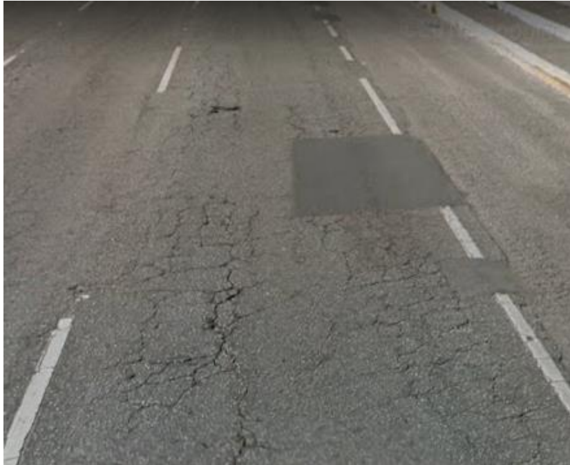
Figura 19 - Defeitos superficiais encontrados na faixa direita - sentido Dias Macedo da Rodovia CE-401
