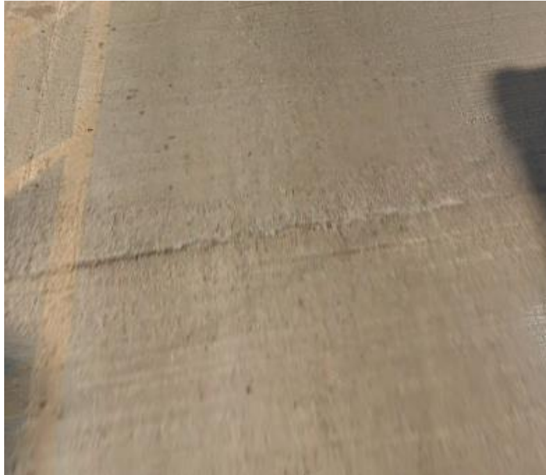
Figura 41 - Trinca localizada na Avenida Dioguinho
