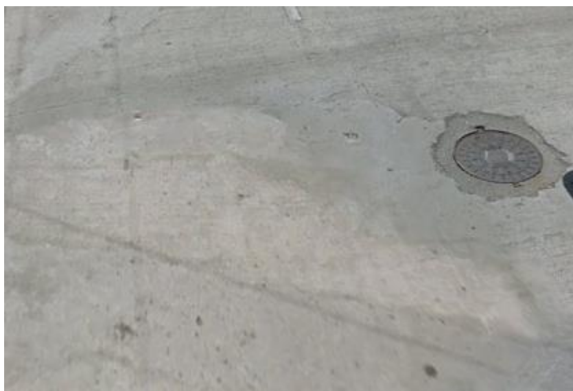
Figura 46 - Tampa de poço de visita e remendo desnivelado na Avenida Dioguinho
