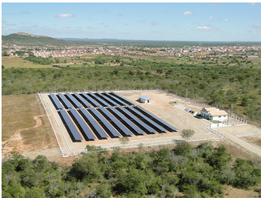
Figura 19. Usina Fotovoltaica de Tauá instalada.
