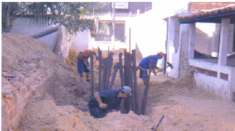
(Fig. 9) Obras de drenagem durante a execução das reformas, muitos transtornos para os moradores e turistas, poeira, barulhos, vias interrompidas, etc.
