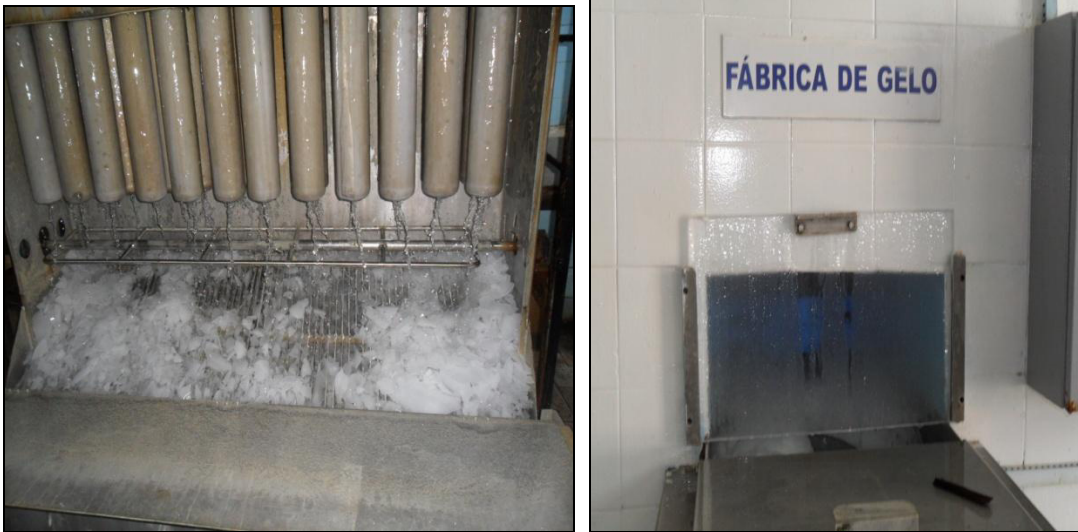
Figura 3 - Fábrica de gelo em escamas e distribuidor de gelo da INTERFRIOS - Intercâmbio de Frios S.A., em Fortaleza, Ceará.
