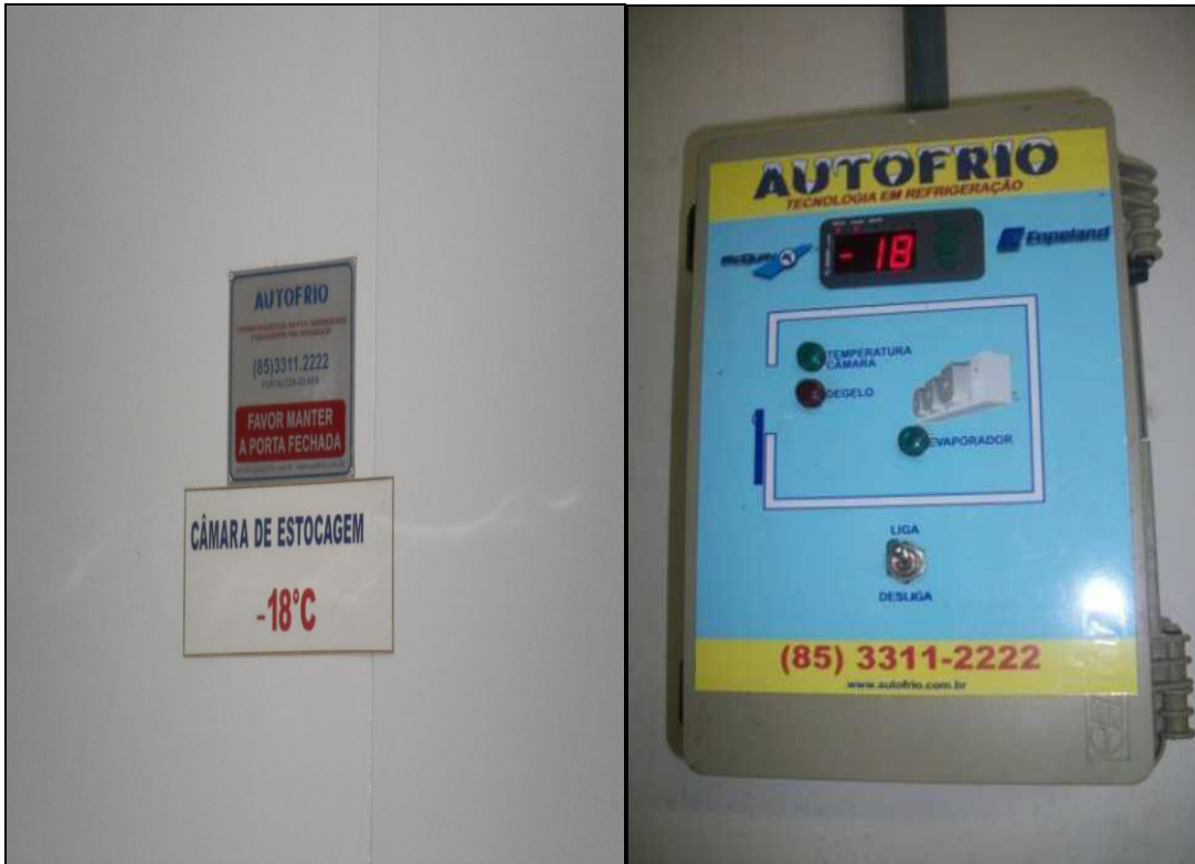
Figura 8 – Câmara de estocagem e registrador digital de temperatura no interior da câmara na indústria INTERFRIOS - Intercâmbio de Frios S.A., em Fortaleza, Ceará.
