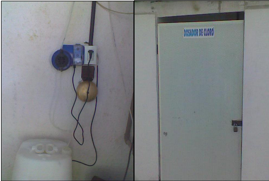
Figura 4 – Dosador automático de cloro que abastece todas as caixas d’água da indústria INTERFRIOS - Intercâmbio de Frios S.A., em Fortaleza, Ceará.
