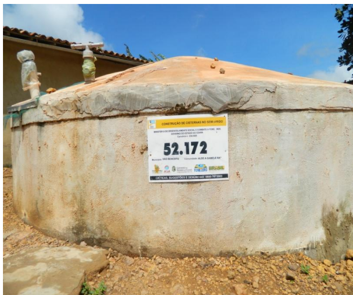
Figura 9: Cisterna de Placa
