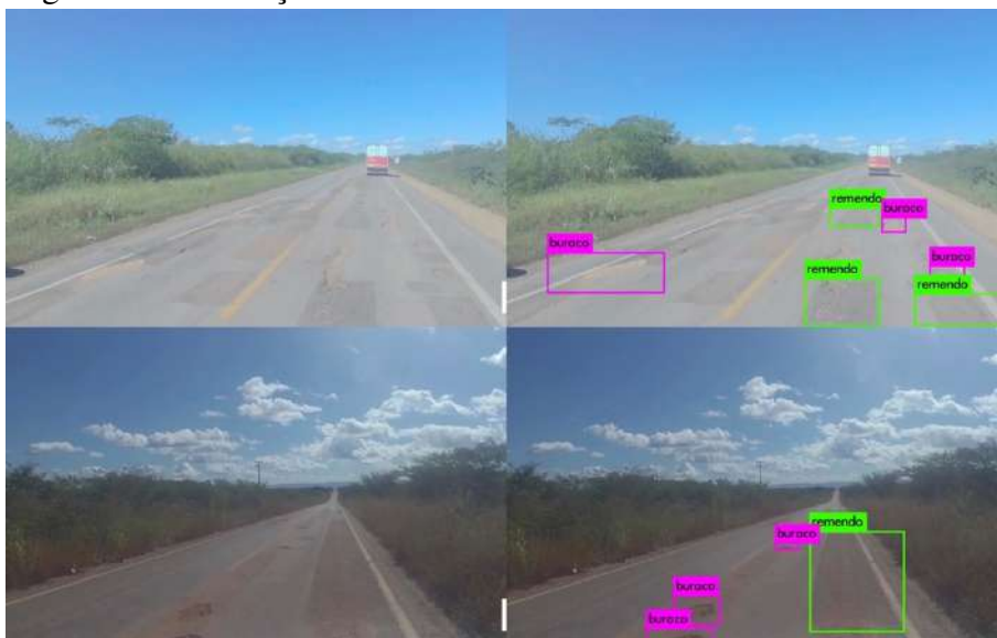
Figura 34 – Detecção de Defeitos no Pavimento Rodoviário
