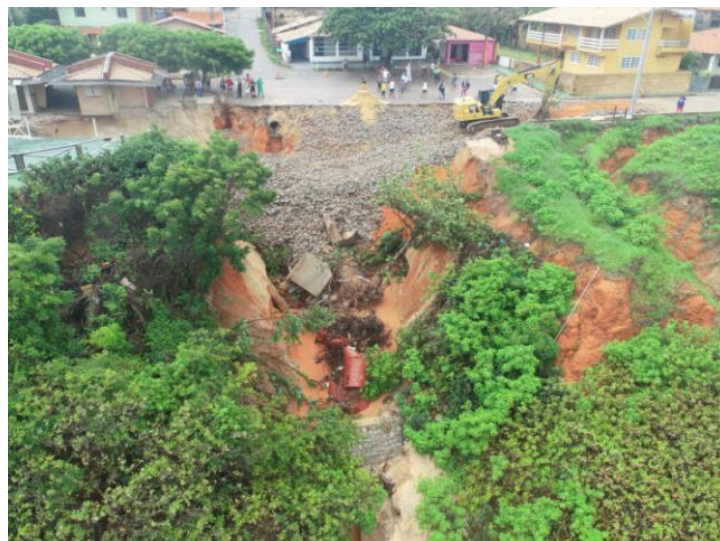
Figura 12 - Deslizamento de falésia na Praia de Morro Branco.
