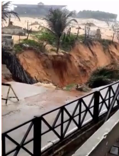
Figura 9 - Deslizamento de falésia próximo ao cemitério em Aracati - CE.
