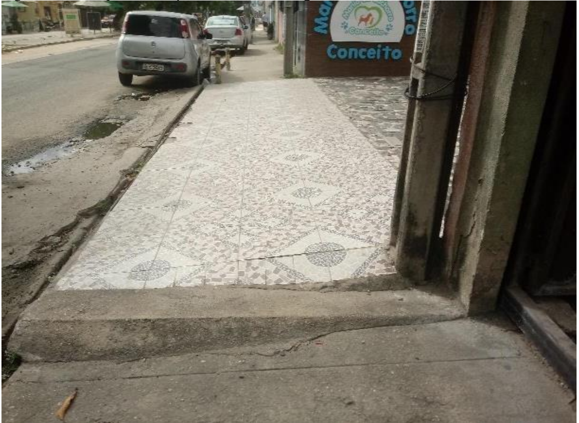
Figura 21 - Calçada com piso liso e escorregadio
