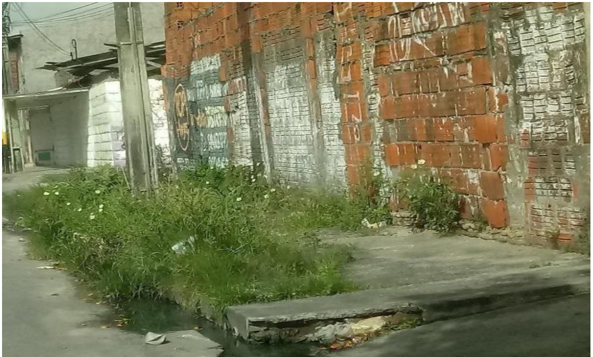
Figura 24 - Calçada sem conservação
