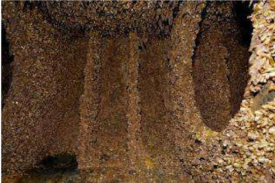
Figura 6: Mexilhões-dourados se proliferam em estruturas metálicas submersas da usina de Itaipu.
