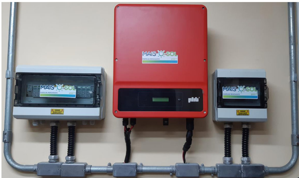
Figura 17 – Detalhe do inversor e proteções CC e CA do SFVCR 01.
