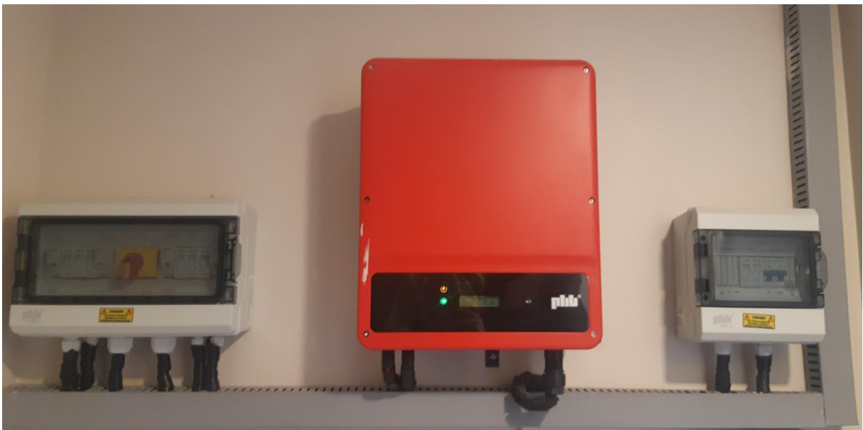
Figura 19 – Detalhe do inversor e proteções CC e CA do SFVCR 02.
