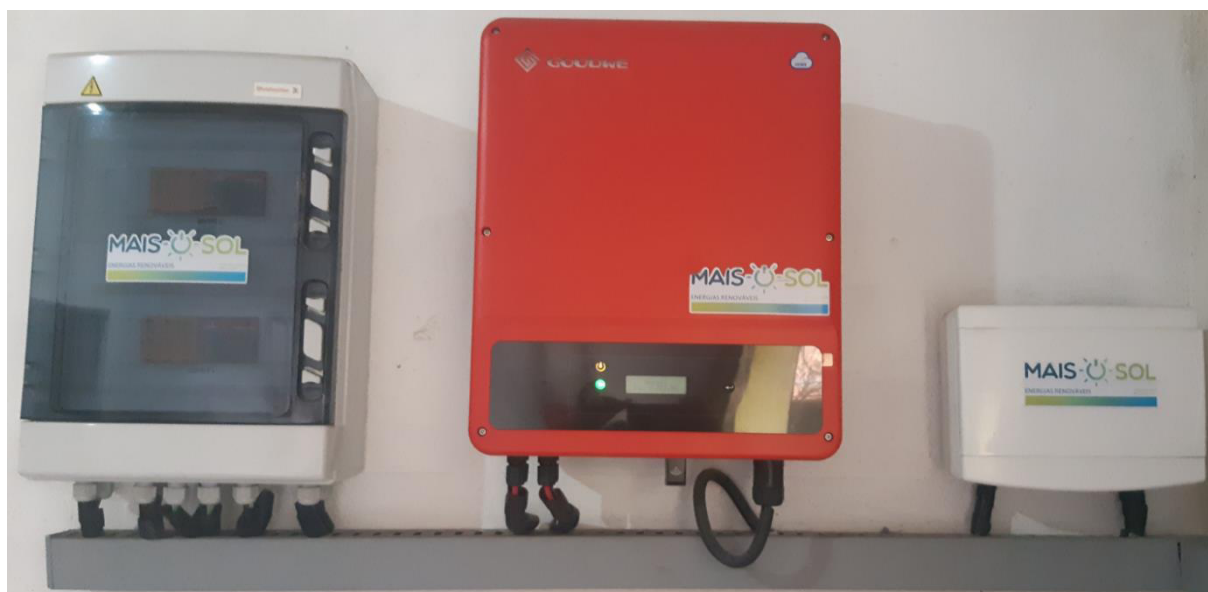
Figura 21 – Detalhe do inversor e proteções CC e CA do SFVCR 03.
