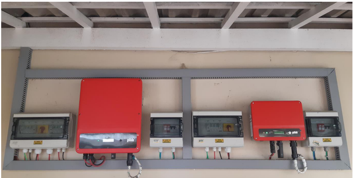
Figura 23 – Detalhe do inversor e proteções CC e CA do SFVCR 04.
