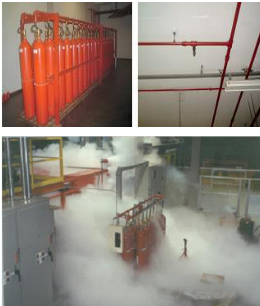
Figura 35 – Sistema Fixo de CO 2 (duas figuras superiores) e sistema fixo de CO 2 em funcionamento (figura inferior)
