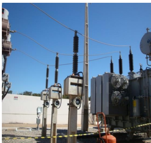
Figura 7 - Para-raios em subestação em Fortaleza - Ceará
