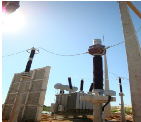
Figura 3 - Transformador de Corrente em subestação de Fortaleza - Ceará
