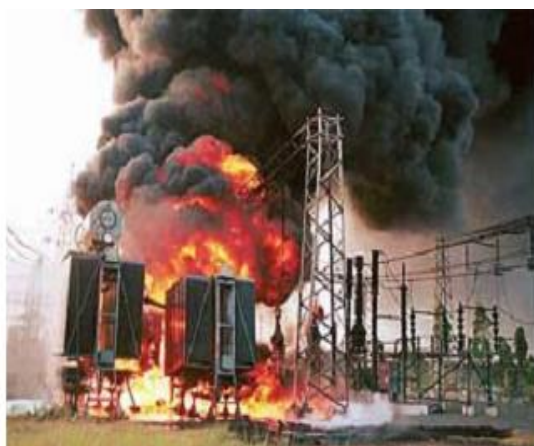
Figura 22 - Incêndio em subestação elétrica
