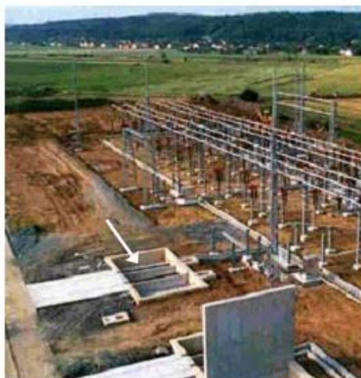
Figura 37 - Bacia de contenção de óleo
