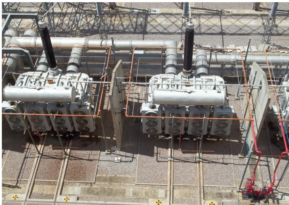
Figura 36 - Sistema de combate a incêndio em uma subestação de 500 kV
