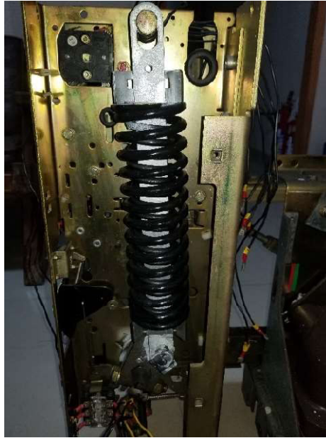
Figura 2- Acumulador de energia (mola) descarregado.
