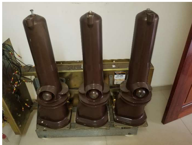
Figura 10- Polos de um disjuntor de alta tensão.
