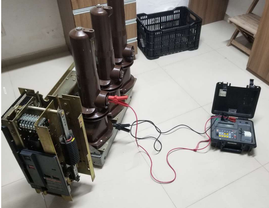
Figura 28 - Ensaio de rigidez dielétrica do disjuntor com os polos fechados
