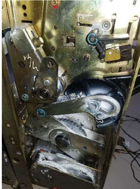
Figura 6 - Conjunto de engrenagens do sistema de operação mecânica do disjuntor.
