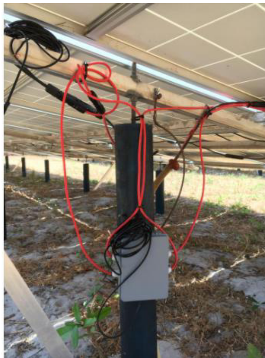
Figura 34 – Sensores plug and play de Corrente instalados
