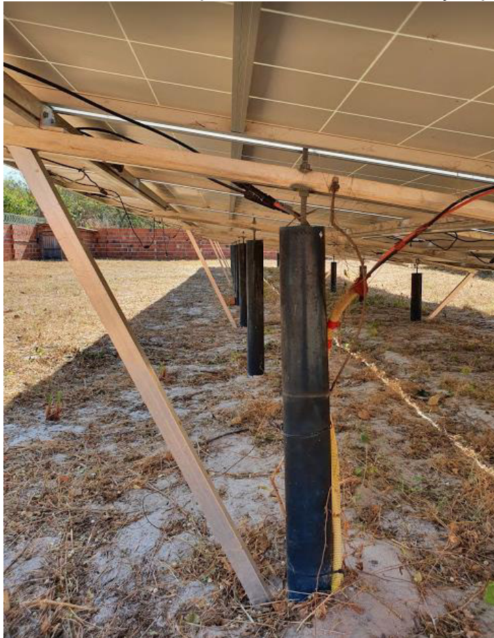
Figura 25 - Local de Fixação do sensor de corrente e fixação do cabo
