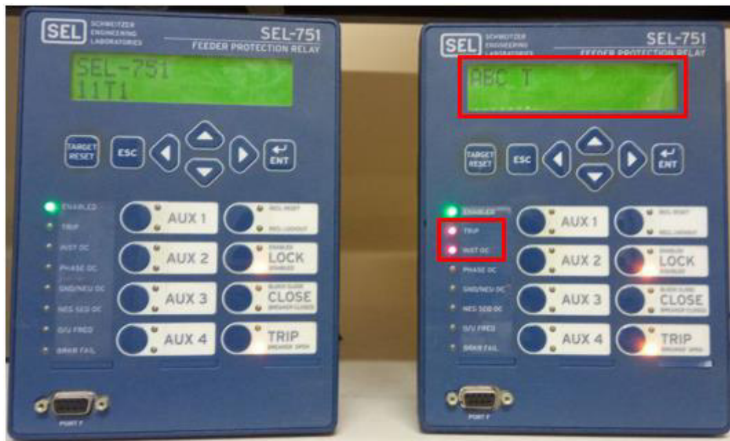
Figura 47 - IEDs físicos após o teste de seletividade lógica sem falha de disjuntor
