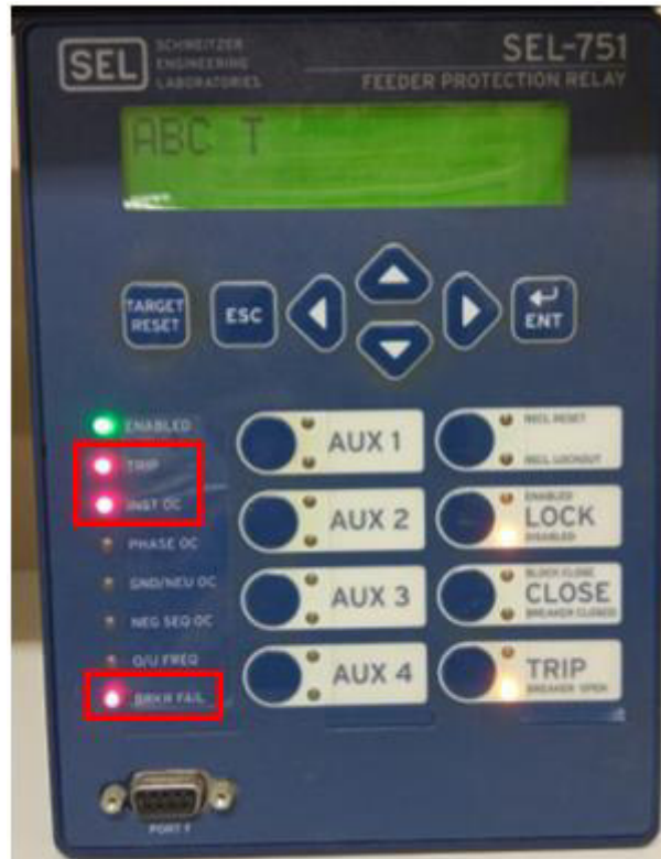
Figura 45 - IED físico pós falta com falha de disjuntor
