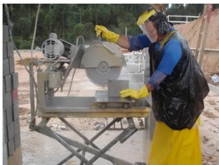
Figura 32: Corte de blocos elétrico em central de corte.
