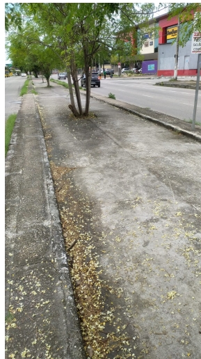
Figura 21 - Trecho 01 Godofredo Maciel, próximo ao Cometa Supermercado.
