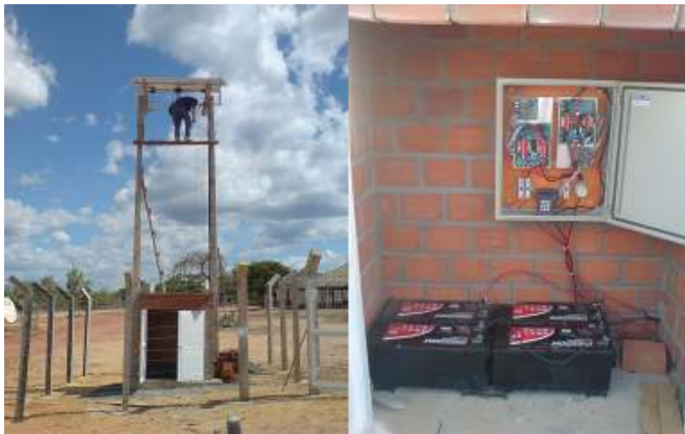
Figura 5.18 – Sistema completo instalado.
