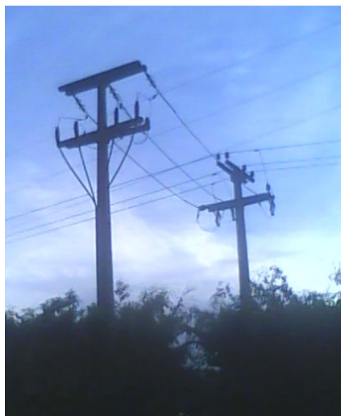
Figura 3.10 – Ponto de Fornecimento de Energia Elétrica (Fonte: Acervo do Autor)
